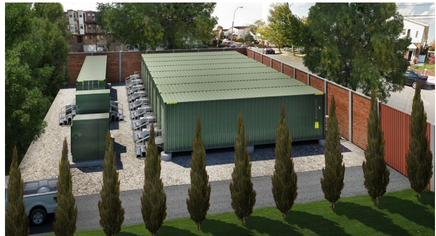
Source: Con Edison
