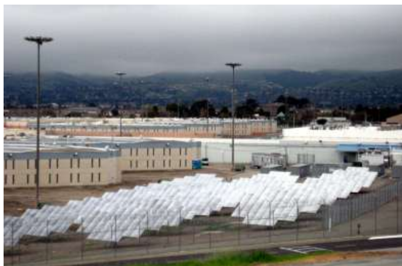
图 4: 斯塔瑞特监狱近照： 地面安装跟踪式太阳能光伏居前、电池和燃料电池居后
