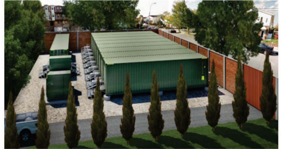
Source: Con Edison
