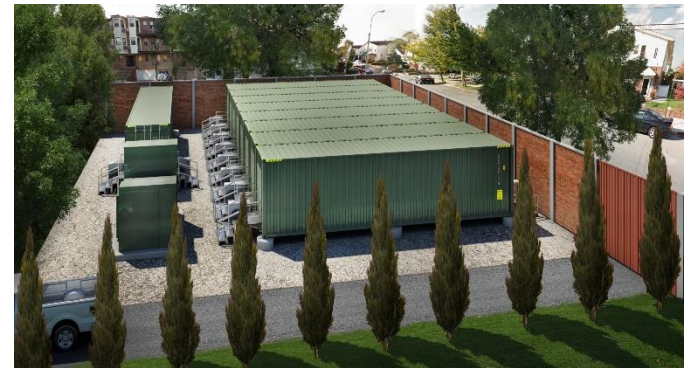
Source: Con Edison
